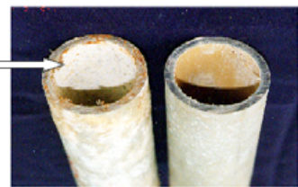
ライニング鋼管に発生したスケール
