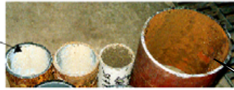
ライニング鋼管に発生したスケール
