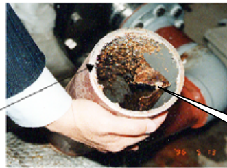
ライニング鋼管に発生したスライム
