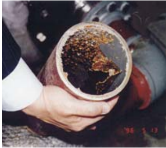
活水設置前の配管の詰まり状態
